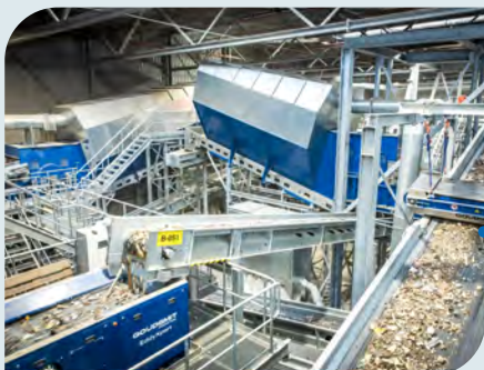
De nieuwe installatie voor bouw-en-sloopafval in Groningen
